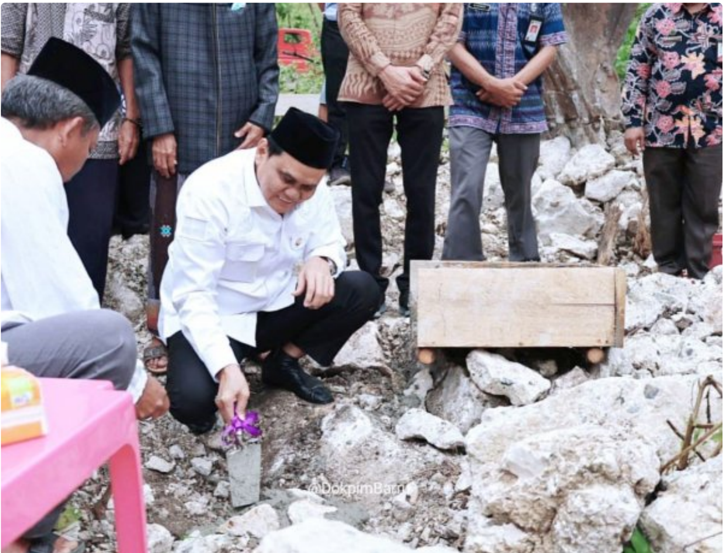
Kegiatan peletakan batu pertama Mushollah Al Barru di Dusun Pange, Desa Palakka, Kecamatan Barru
